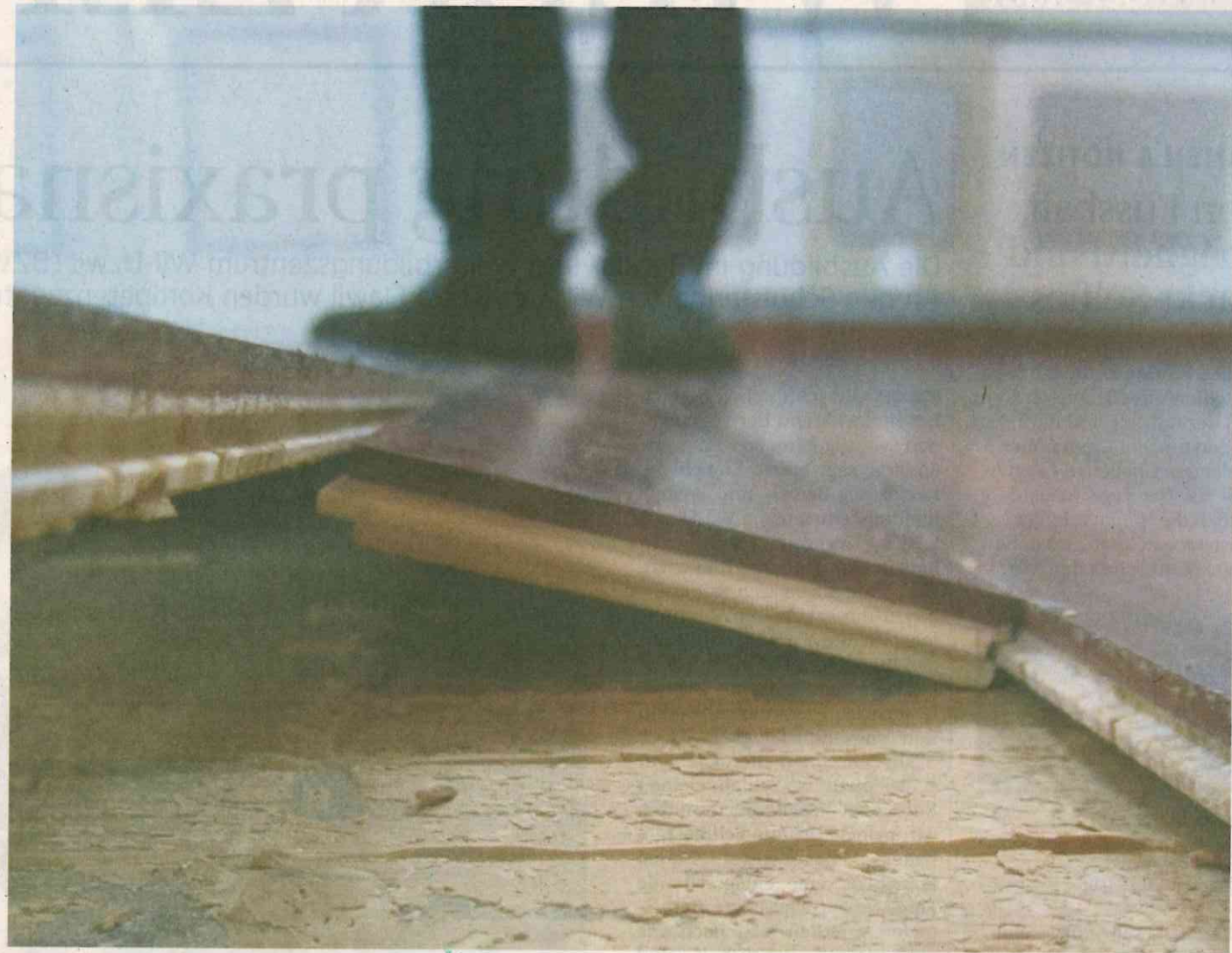
Der nur gerade drei Jahre alte Parkettboden im Dreitannen-Saal hat sich wegen eines fehlerhaften Leims vom Boden gelöst.
